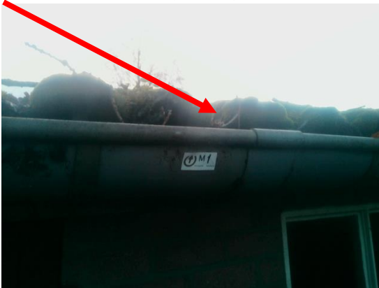
Foto 5 | Golfplaten op het dak
