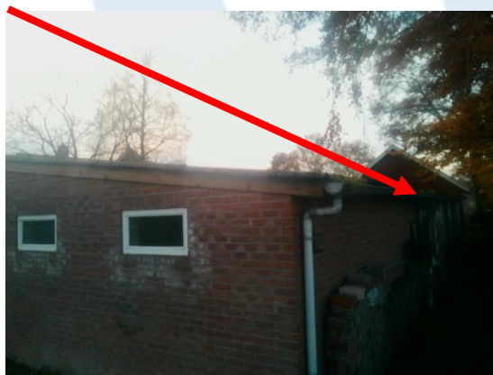
Foto 1 | Golfplaten op het dak
