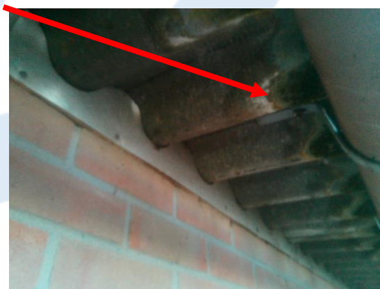
Foto 2 | Golfplaten op het dak
