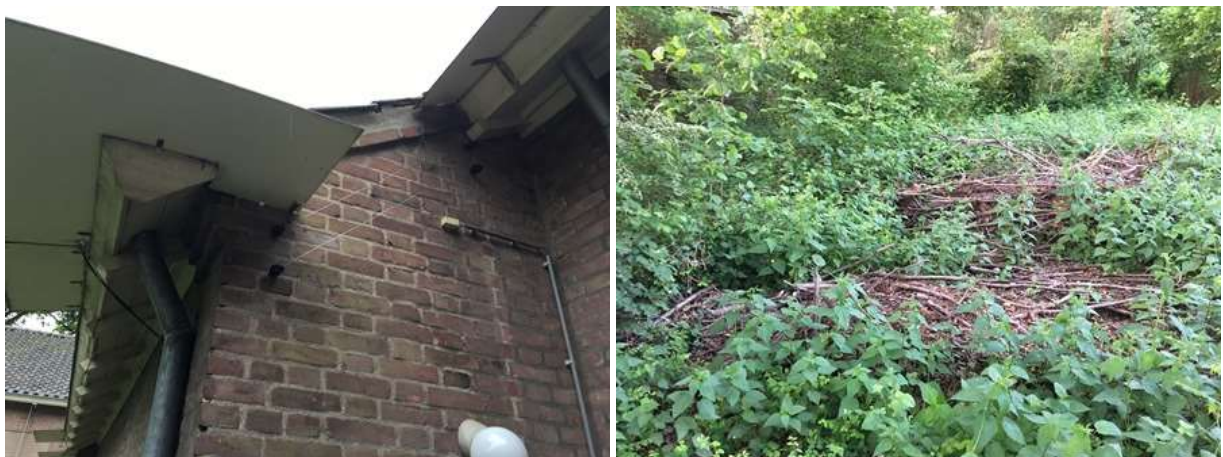
Foto links: getroffen maatregelen om steenmarters te weren uit de bebouwing. Foto rechts: takkenbossen in het plangebied. Potentiële verblijfplaats voor kleine zoogdieren zoals de egel.
