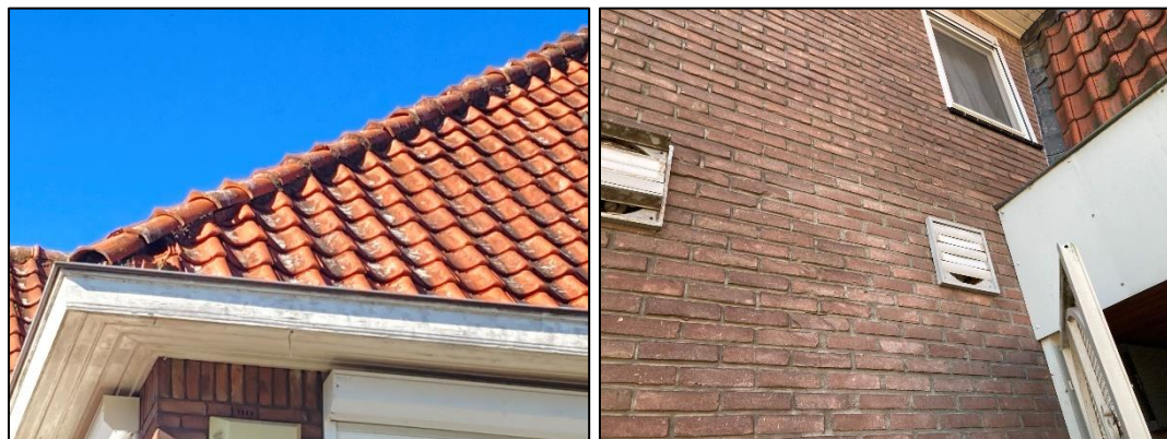
Figuur 6.3 (links): Een opening tussen de dakpannen (rood omcirkeld); Figuur 6.4 (rechts): Open ventilatierooster aan de buitenmuur.
