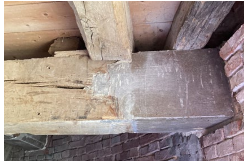
Hoognodige reparatie, ten aanzien van behoud houtwerk.
