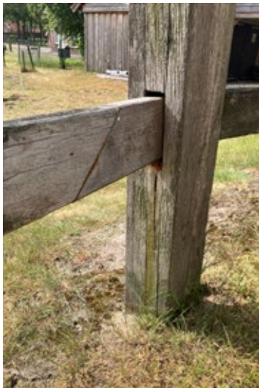
Hoognodige reparatie, ten aanzien van behoud houtwerk
