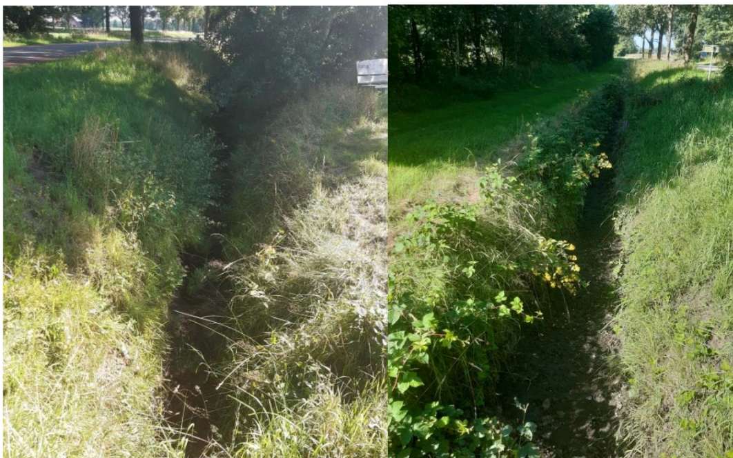
Figuur 4.8: Sloop in de oostelijke berm van de Frensdorferweg. Gezien richting het noorden (foto links, stroomafwaarts) en zuiden (foto rechts, stroomopwaarts).
