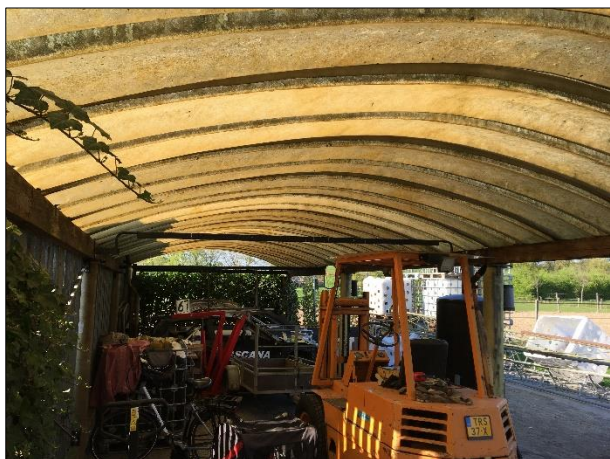
Mogelijke rust- en/of voortplantingslocatie van grondgebonden zoogdieren tussen opgeslagen goederen en rommel.
