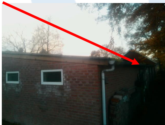
Foto 1 | Golfplaten op het dak
