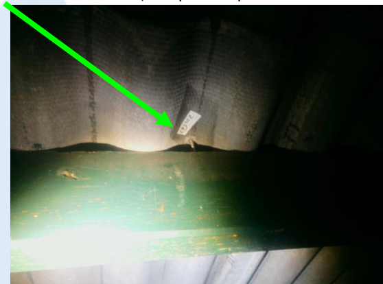
Foto 6 | Golfplaten op het dak
