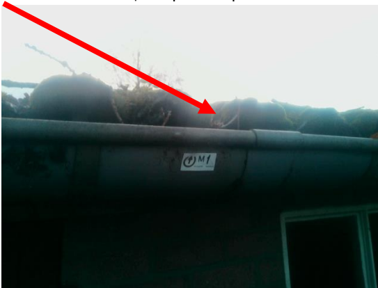
Foto 5 | Golfplaten op het dak
