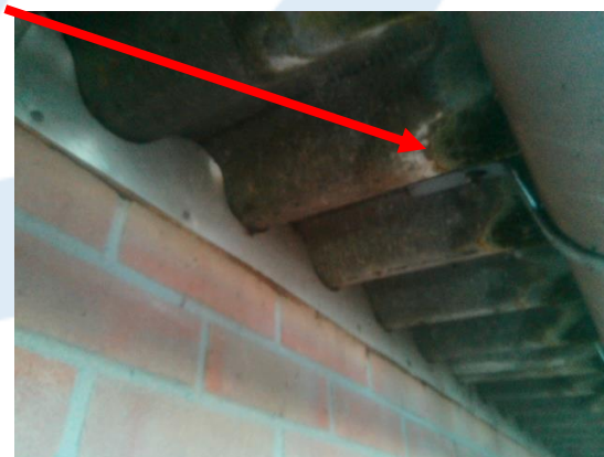
Foto 2 | Golfplaten op het dak
