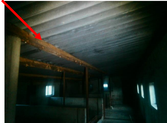
Foto 4 | Golfplaten op het dak
