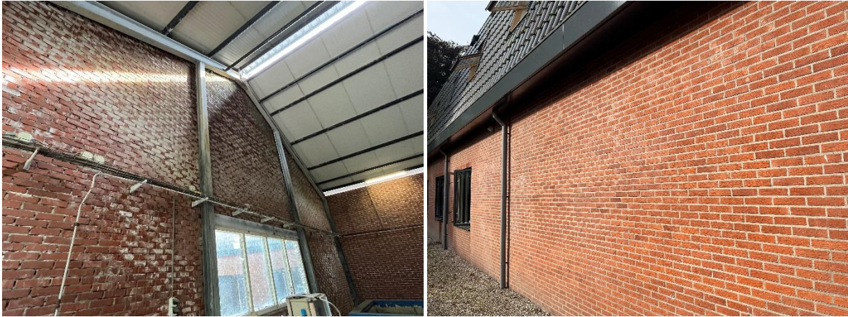
Foto links: halfsteens gevels in de loods. Foto rechts: aanzicht van de buitengevel zonder potentiële invliegopeningen.
