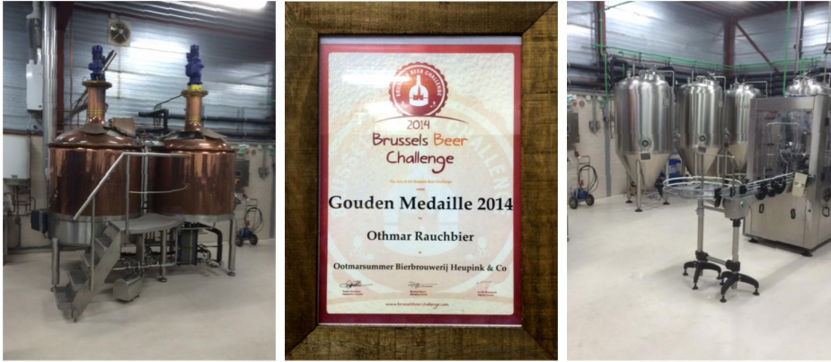
Brouwketels en lager- en gistingstanks bij Othmar bierbrouwerij.
