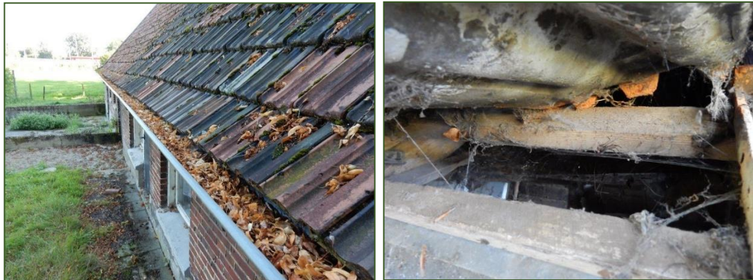
Foto's: Ontoegankelijkheid dak door bladeren en rechts het ontbreken van dakbeschot.
