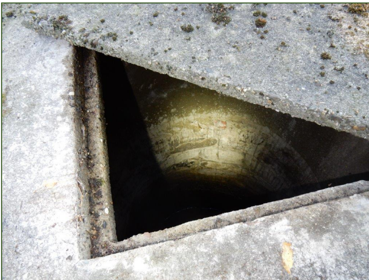
Foto: Ontbreken planten in waterput.
