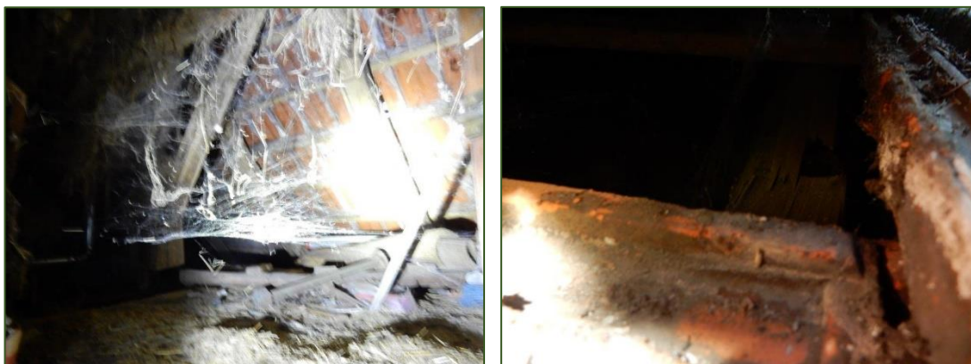
Foto's: Veel spinnenrag op zolder en ontbreken dakbeschot bij dakpannen.
